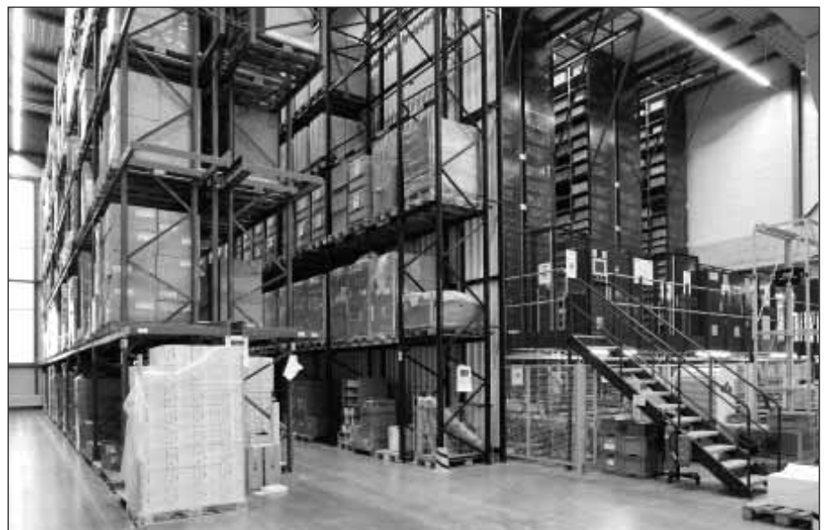
Abb. 3: Lagertechnik im Logistikzentrum (HRL+AKL)
